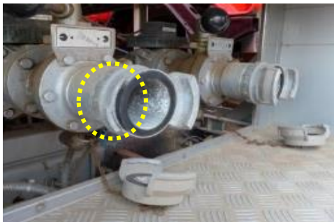
ホース接続部分の腐食
