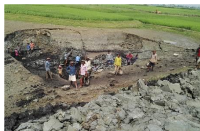
川岸の修繕を行う WMCA メンバー (Kalagang Roar Haor SP シレット圏)
