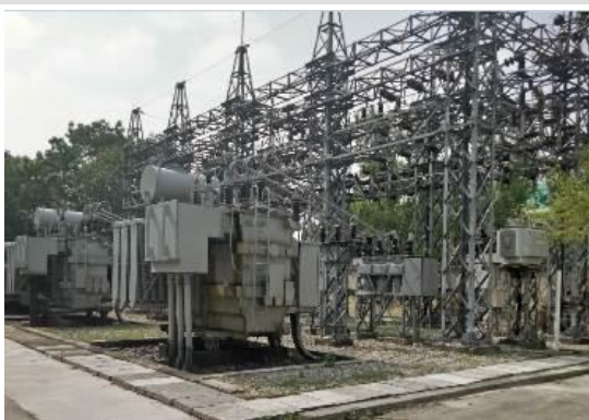
改修された変電所（Tangail、シレット）
