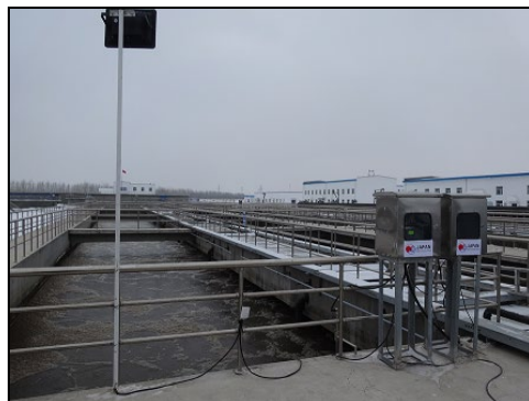
奎屯市汚水処理場（活性汚泥槽）
