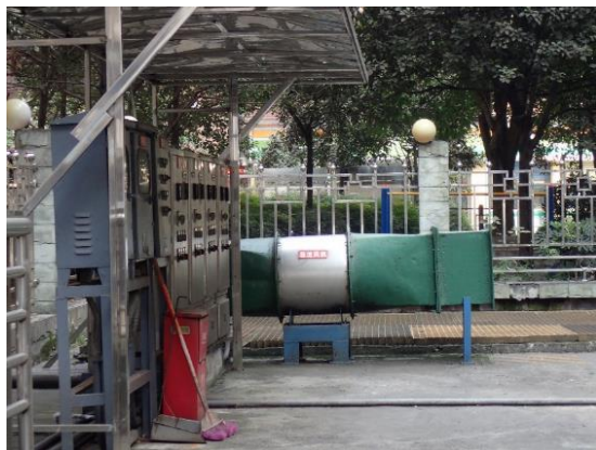
宜賓市のポンプ場
