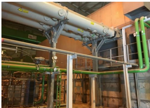
写真3：蒸気タービン室
