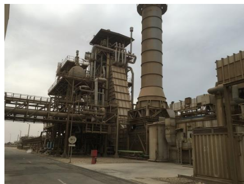
本事業により整備された発電施設
