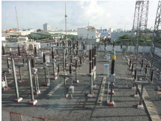
ビンツリードン変電所（ホーチミン市）
