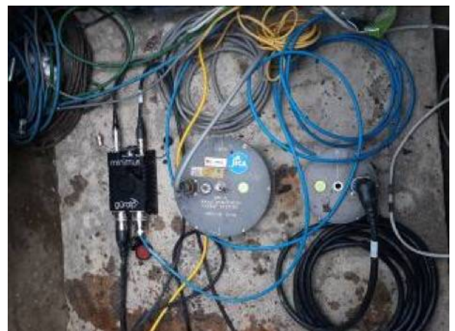
加速度計はすべて稼働中で、TDMMO により適切に管理されている
