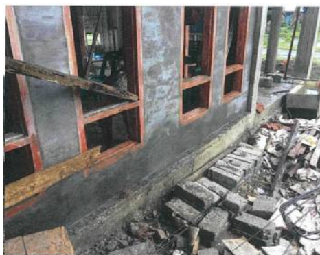
ニアス県において、基礎が完成した耐震ノンエンジニアド住宅
