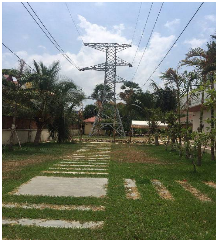
電力大学に設置されている訓練塔
