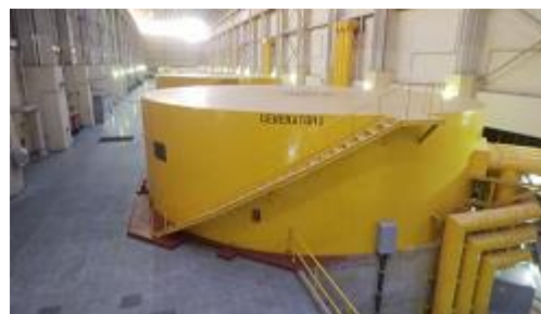
ジェバ水力発電所発電機室 手前が1号機、一番奥が6号機
