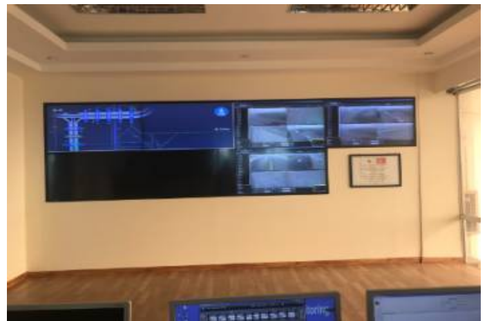
オペレーションルーム
