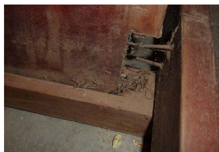
写真2. 家具のたわみ、ひび割れ
