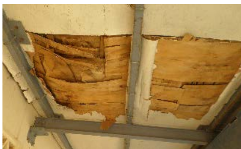
写真1. 雨漏りによる天井の劣化
