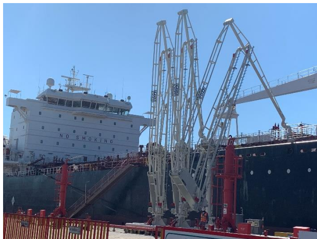
北埠頭に設置されたローディング・アーム
