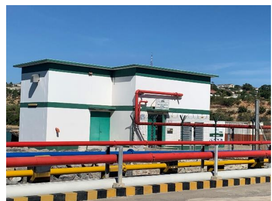
消火施設(ポンプ施設)
