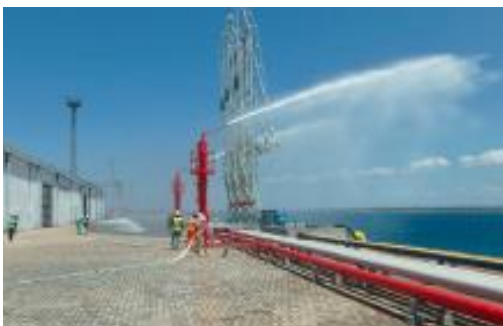
消火設備による定期的な放水確認
