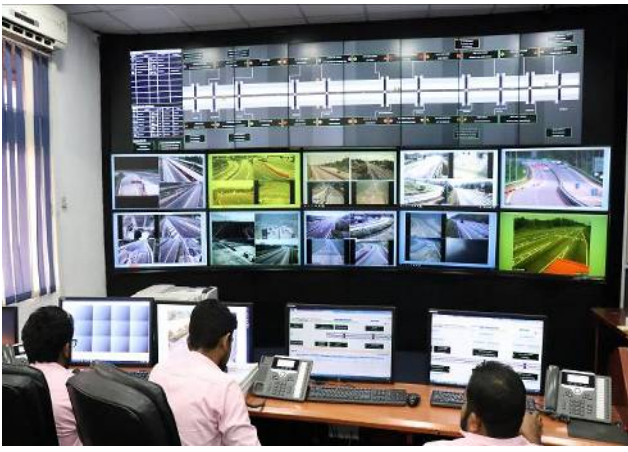
EOM&M の交通管制センター
