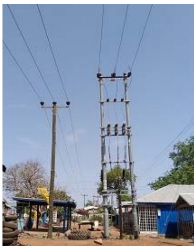
34.5kV 準送電線（右）（タマレ地区）
