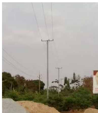
11.5kV 配電線（スンヤニ地区）
