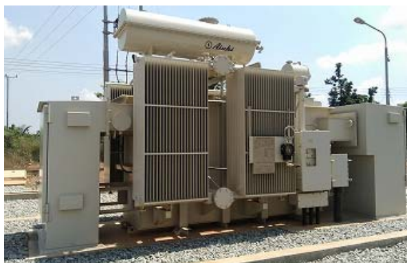
主変圧器 (スンヤニ第一次変電所)
