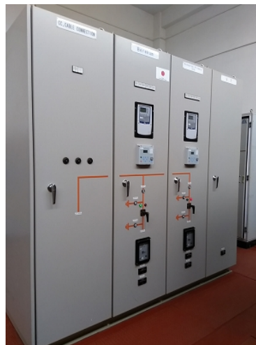
スンヤニ境界変電所に設置した 34.5kV 配電盤
