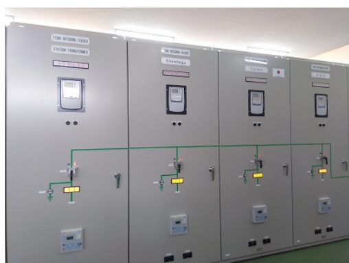
11.5kV 配電盤 (タマレ第一次変電所)
