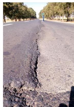
ブラックコットンソイルの影響を一因とする路面の段差
