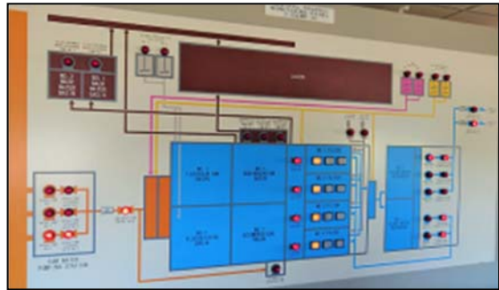
浄水場のコントロールパネル
