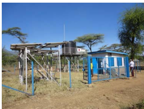
ソーラーパネル、貯水タンク、水販売所
