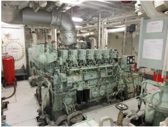
エンジンルーム内
