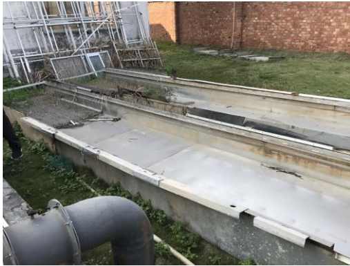
破損した粗目スクリーン
