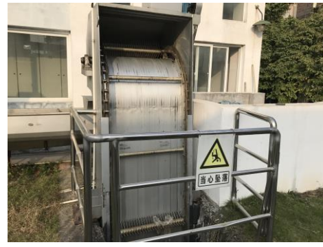
南門塘下水ポンプ場（粗目スクリーン）
