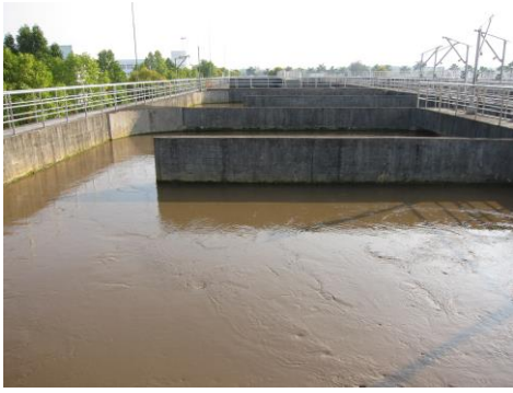
玉林市下水処理場（生物反応池）
