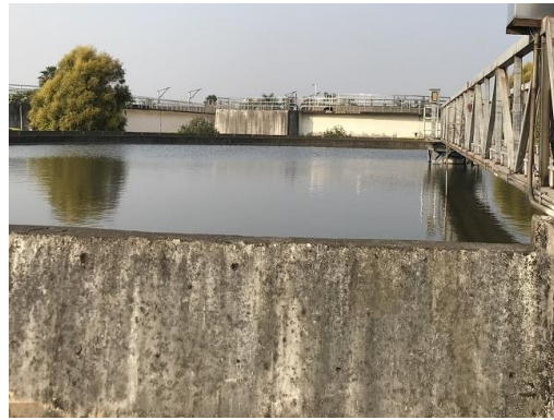
コンクリート部の劣化箇所
