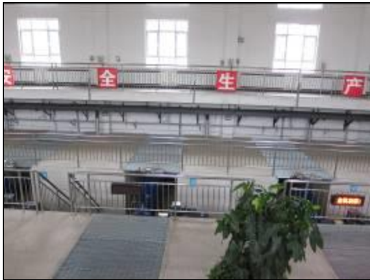
第5浄水場(ポンプ場)
