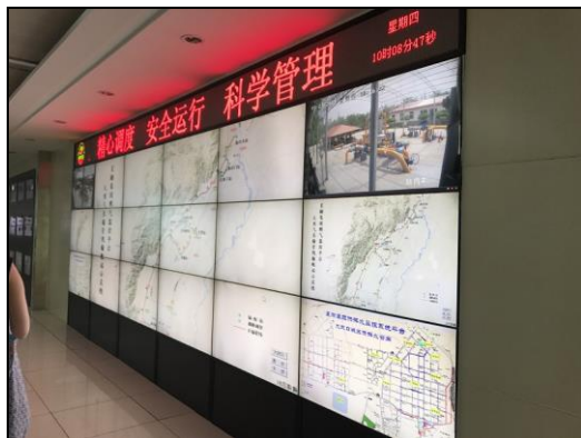
実施機関中央制御室(石嘴山市)
