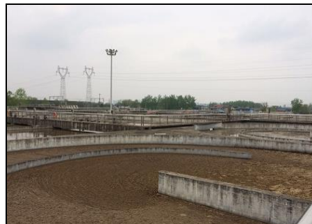
本事業により整備された蚌埠第二污水处理場の反応タンク
