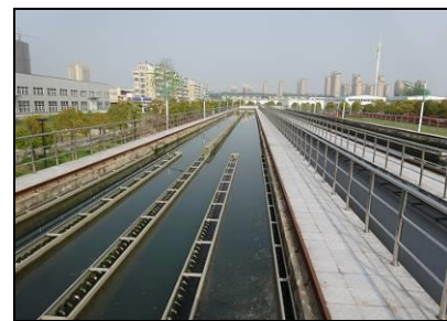
本事業によって整備された懷遠県蚌埠中央環境水道有限公司第 1 浄水場の沈澱池
