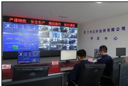
本事業により整備された蘭州范坪熱網有限公司のコントロールステーション
