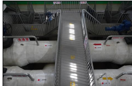
本事業により整備されたバルブ室
