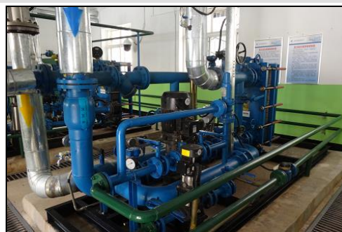
本事業により整備された熱交換ステーション（七里河区）
