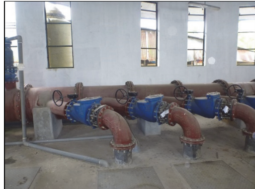
ポンプ場内部
