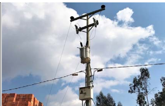
本事業による配電施設
