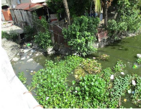
本事業対象地域に隣接する、沈殿物・表面植物除去の必要のある排水路
