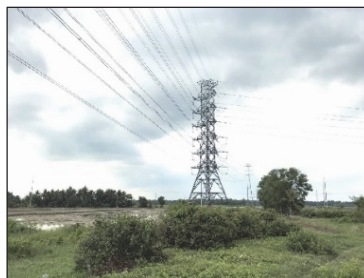
写真 2 220kV Duyen Hai – Tra Vinh 送電線
