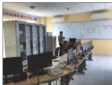
写真 7 My Tho500kV 変電所オペレーター室
