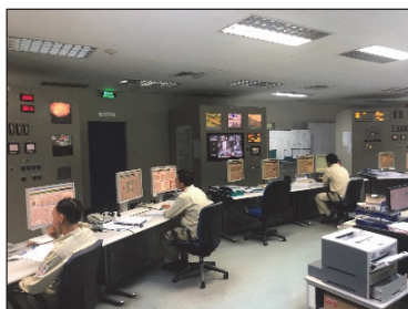
写真 6 オモン発電所 オペレーションセンター
