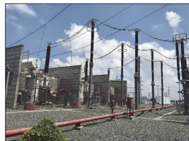
写真 3 500kV Duyen Hai 変電所
