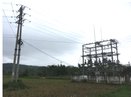
写真 4：整備された配電網・変圧器
