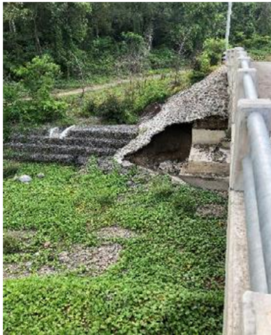
橋台保護工の崩壊（モネ I 橋）
