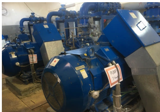
写真1：ハラバットポンプ場の ポンプ設備
