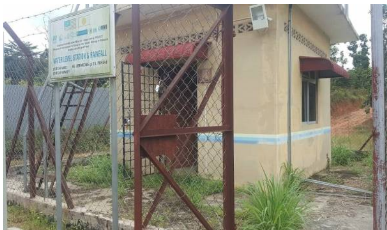
写真 1 (UNITEN 提供) : 洪水監視のために調達した機器 (水位・降雨観測所) の一つは、現在も UNITEN と DID で使用されている。
