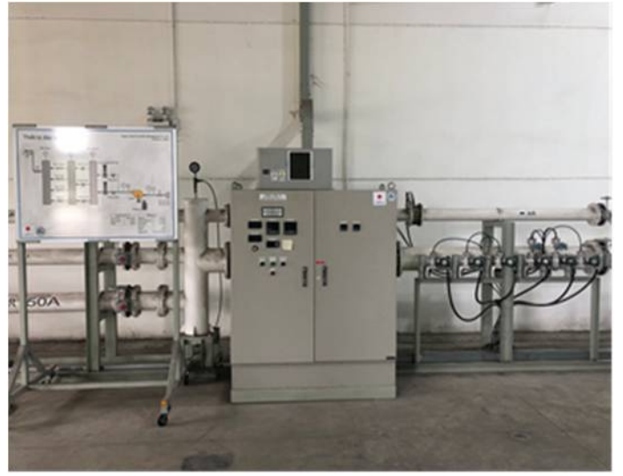
HCMC 省エネルギー研修センターの研修設備
