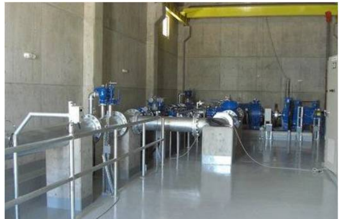
ピカチヨ発電所建屋内 全景
