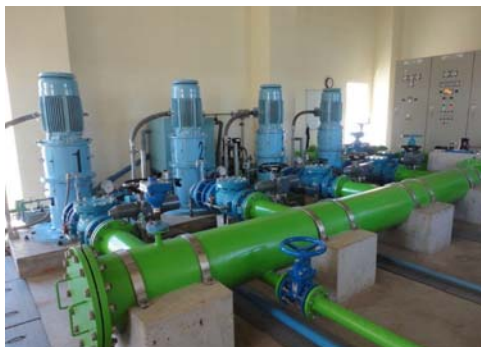
取水ポンプ (コンポンチャム)
