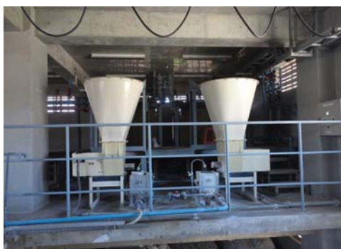
薬品注入設備（コンポンチャム）
