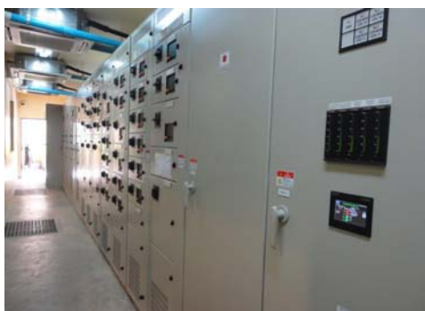
ポンプ場操作室（バットバン）
