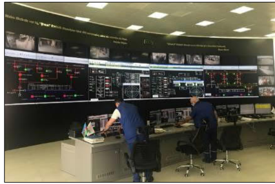
写真右：コントロールルーム
