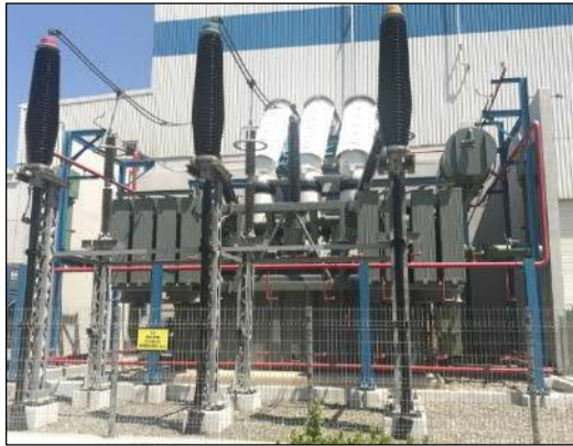
写真左：主変圧器
