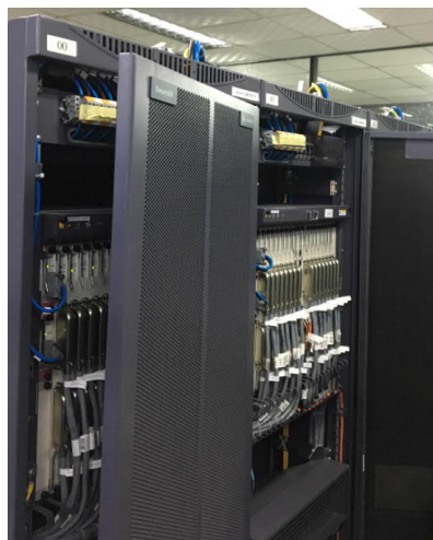
本事業で設置したインターフェース機器
