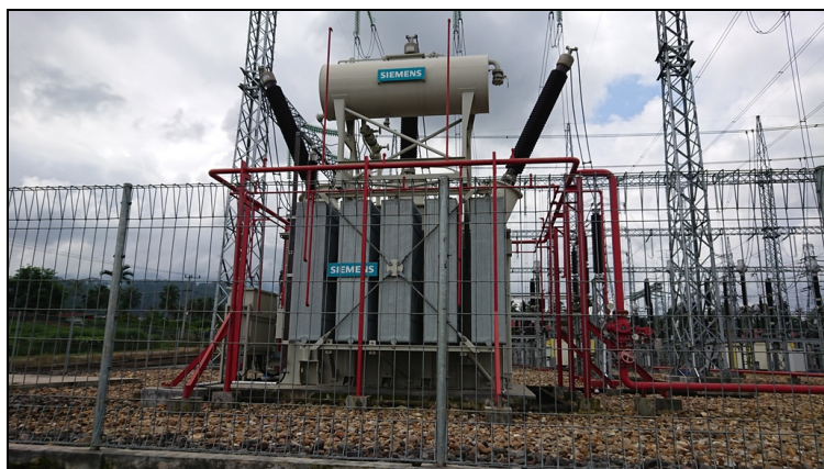
本事業により増設されたパクンブ変電所（西スマトラ州）
