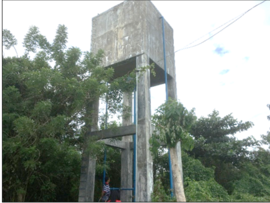
写真 3：整備された上水施設 (イロコス・ノルテ州)
