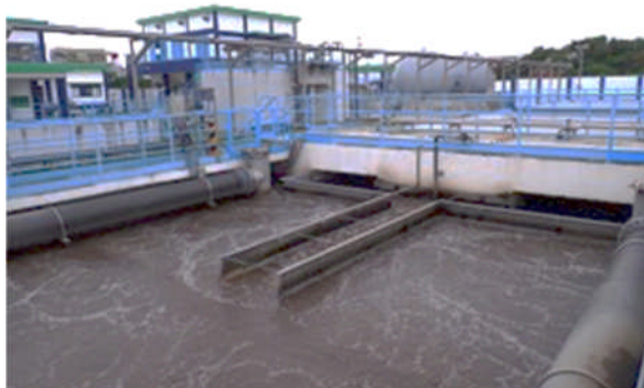
本事業により整備された下水処理施設
