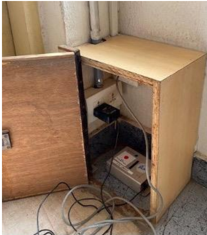
IITH 建物内に設置された強震計センサー（ITK センサー）で常時監視を実施
