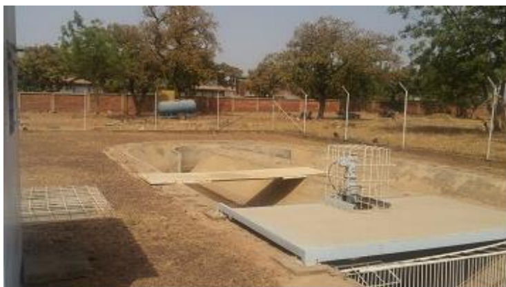
2iE カンボワンセキャンパスに設置された高速藻類池排水処理プラント
