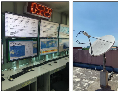
本事業によって整備された機材 (PHIVOLCS 本部 モニター、IPSTAR 衛星通信機材)
