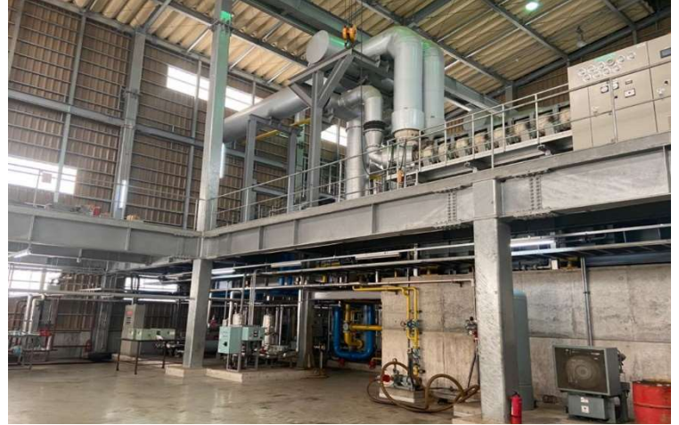
発電所棟内観
