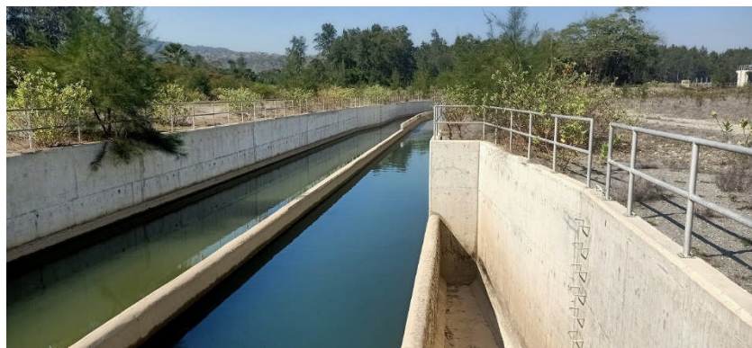
写真 1：本事業で整備された灌漑施設（幹線水路）①
