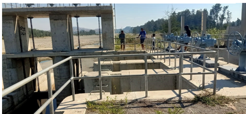
写真 3：本事業で整備された灌漑施設（頭首工）
