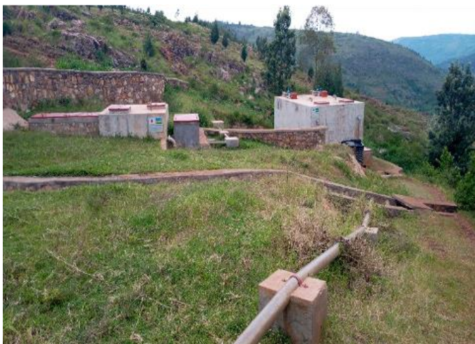
湧水取水施設（左）、集水槽（右）、送水管（手前） （ンゴマ郡ルキラセクター（ルキラ東サイト））
