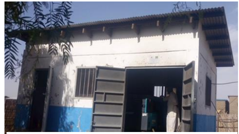
発電機室（Mito）
