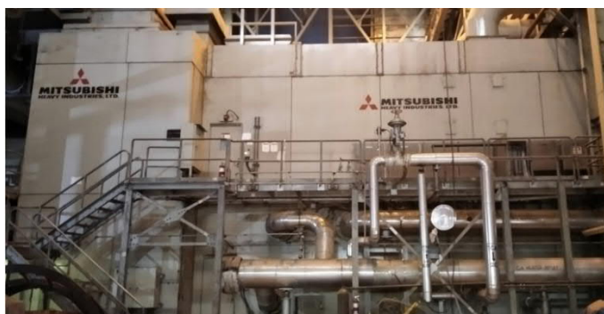
写真 ガスタービン
