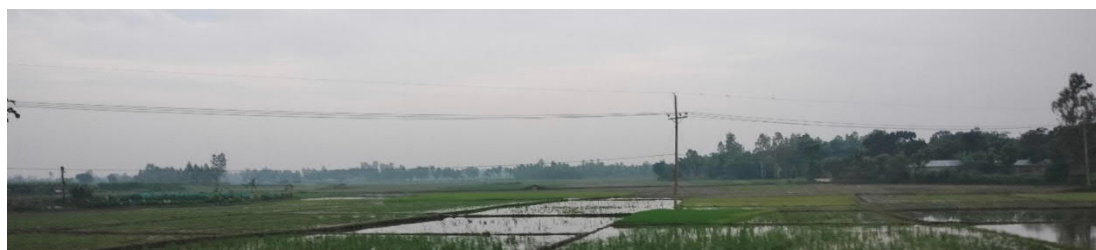
写真 新設された中低圧線（33kV 電線）（ランプール管区 Dinajpur PBS-2）
