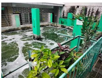
写真2 排水処理施設
